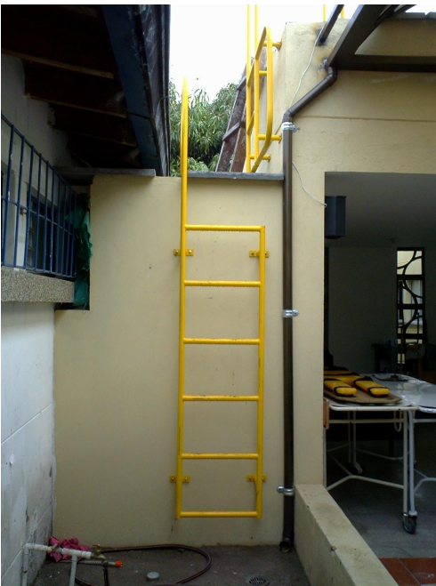
Foto 14. Estación Copacabana, adecuación de acceso a la terraza donde se encuentra el equipo de Hi-Vol.
