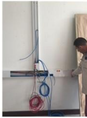
Readecuación y mantenimiento de redes eléctricas, voz y datos, en diferentes espacios del campus Robledo.
